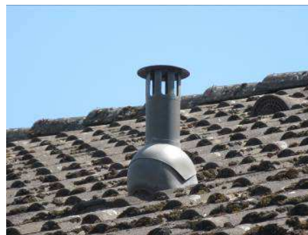
Foto: typische Dachentlüftung
